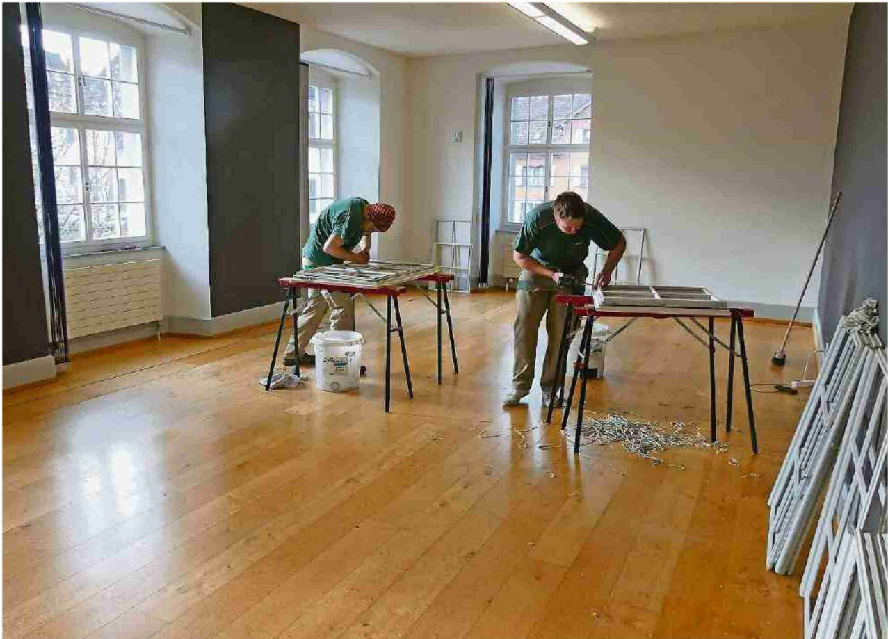
Die Handwerker sind an der Arbeit und montieren die speziellen Fenster im künftigen Museum Caspar Wolf. EDDY SCHAMBRON
