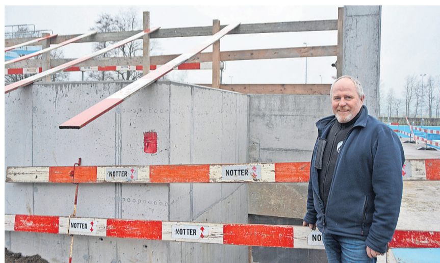
Betriebsleiter Martin Burkart vor dem Notausgang und dem Lift. Von aussen wird für die Badi-Gäste nur dies von der grossen Sanierung der Badewassertechnik zu sehen sein.
